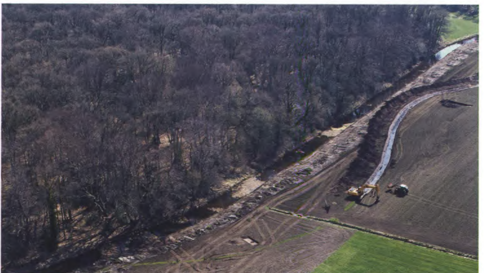
Het terugbrengen van de Hagmolenbeek naar de situatie voor kanalisatie is een belangrijk uitgangspunt. Hier is de eerste aanzet voor de nieuwe beekloop gegeven. Met de vrijkomende grond wordt de 'oude' beekloop gedempt.
